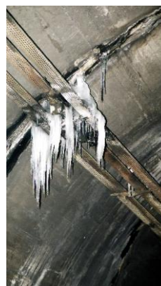
Crédit photo CEREMA – Stalactites de glace sur un chemin de câbles en voûte de tunnel
