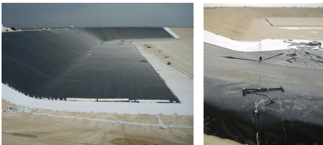
Crédit Photo YGD CONSEIL – Contrôle de la pose des géosynthétiques et des soudures
