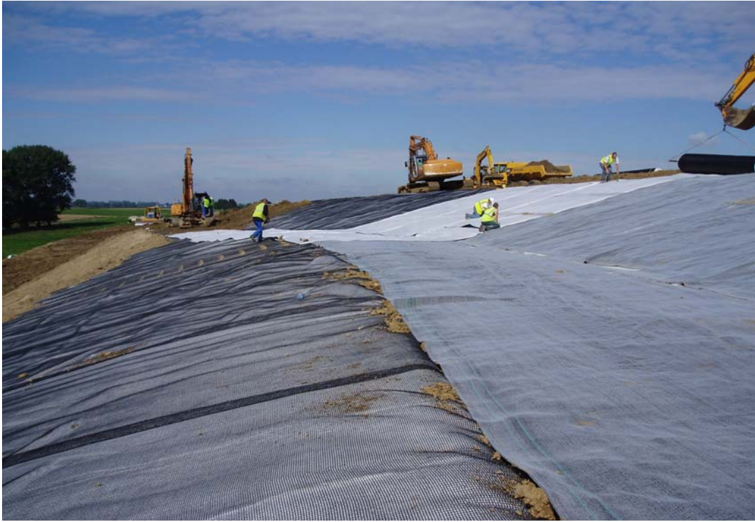
Photographie 3. La constitution précédente + le renforcement + le recouvrement de l'ancrage (SITA Nord – SCETAURROUTE)
