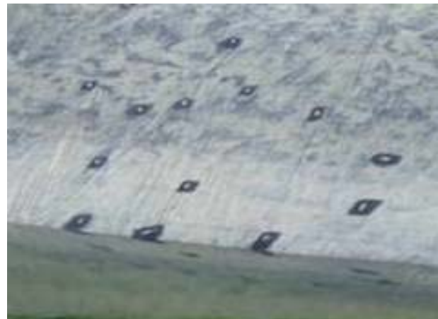
Figure 5. Nombreuses perforations de la géomembrane par effet de rabotage par la glace
