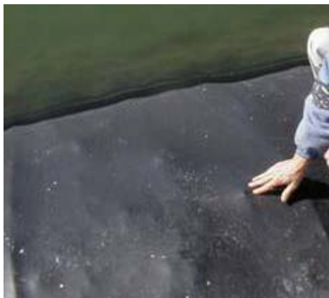
Figure 6. Exemple de support trop agressif
