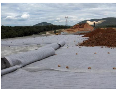
Drainage de couverture, installation de stockage de déchets de Donzère (26) – crédit photo CFG
