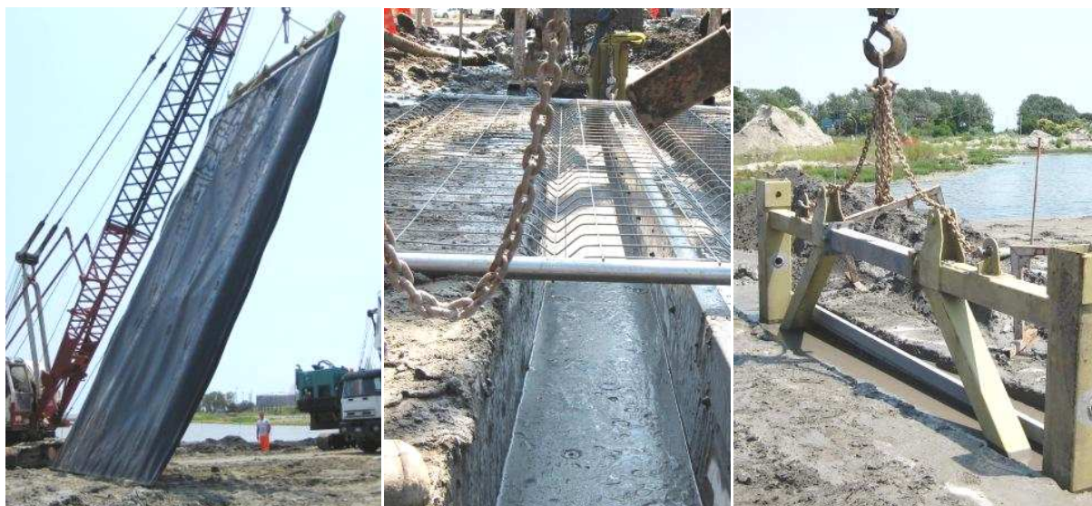
Confinement in Situ : différentes étapes de la mise en œuvre d'une palfeuille PEHD dans une tranchée au coulis bentonite/ciment ; Meusy (2009)
