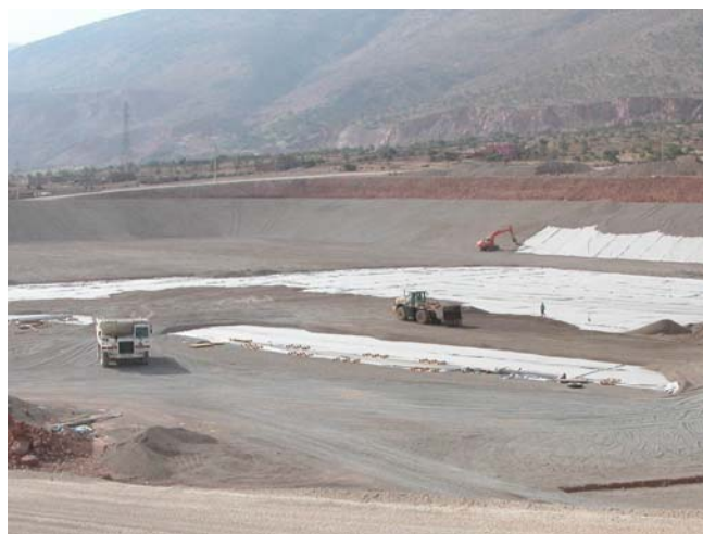
Figure 12. Mise en œuvre de la couche de confinement sur le bassin inférieur; dumper et chargeur sur le fond, pelle mécanique sur talus
