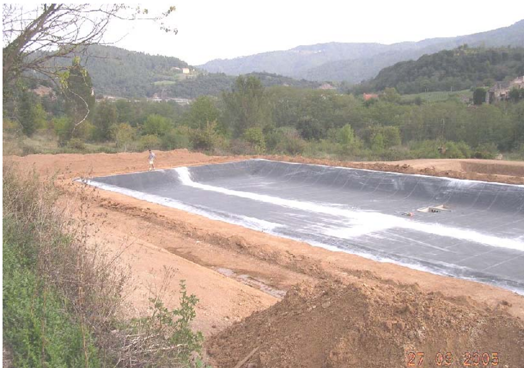
Figure 3. Installation d'épuration des eaux usées de Saint-Fortunat sur Eyrieux (07) Capacité de 700 EH - Etanchéité 1 er étage FPR par géomembrane EPDM
