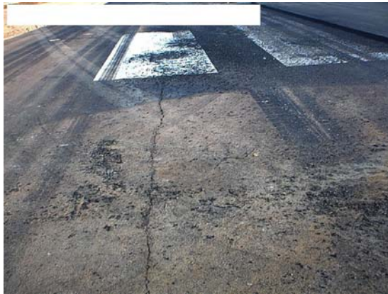
Figure 5. Fissure longitudinale de remontée après la mise en œuvre de la GB 0/20
