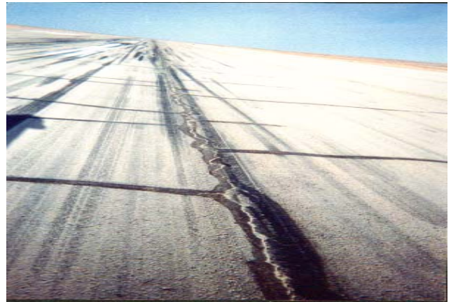
Figure 2. Fissure longitudinale de joint
