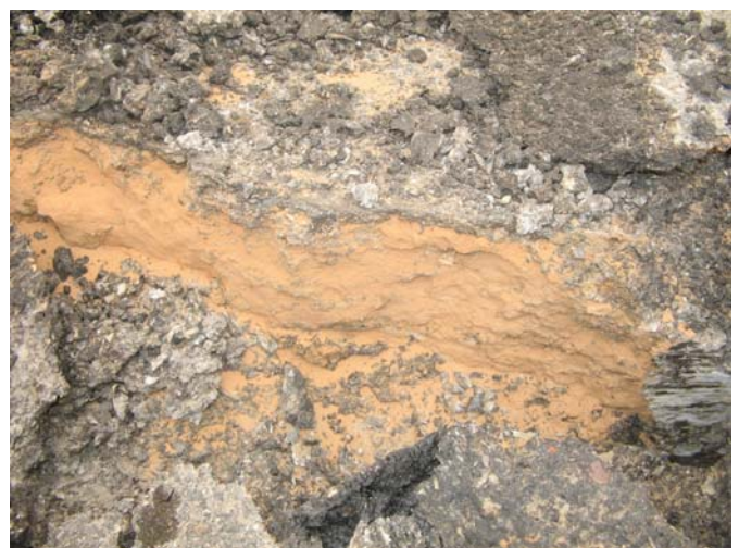
Figure 4. Fissure envahie par le sable éolien
