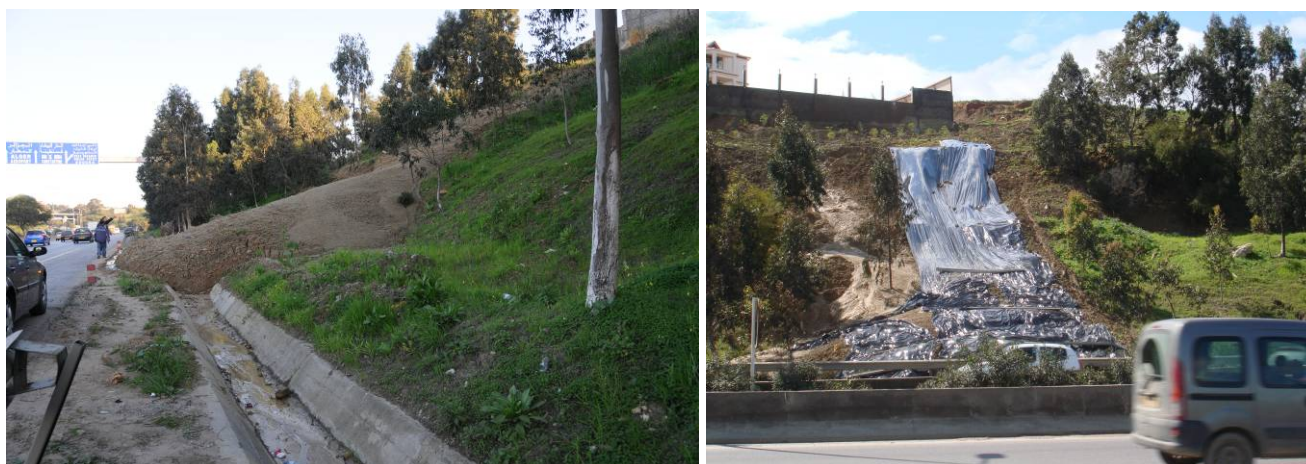
Figures 1 et 2. Vues de la voie rapide et de la coulée de boue.
