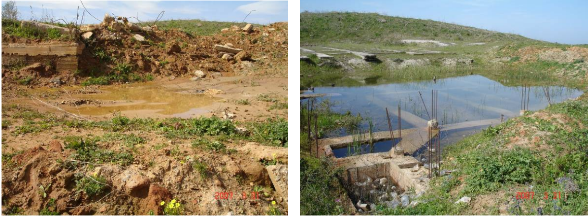
Figures 3 et 4. Stagnation des eaux en amont dans des fondations abandonnées
