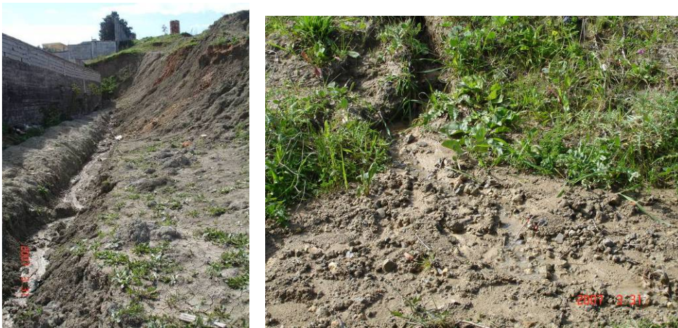
Figures 5 et 6. Alimentation en eau de la zone glissée par ruissellement
