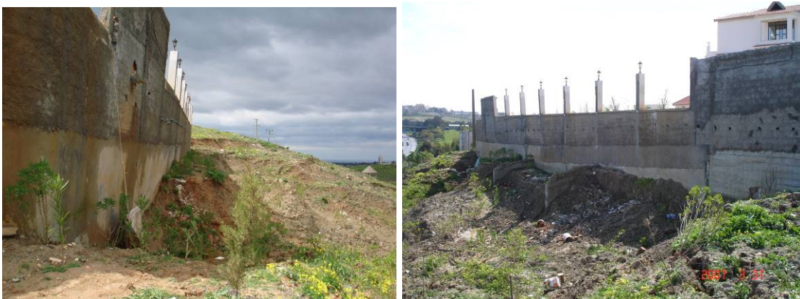
Figure 7 et 8. Alimentation en eau de la zone glissée à partir du lotissement
