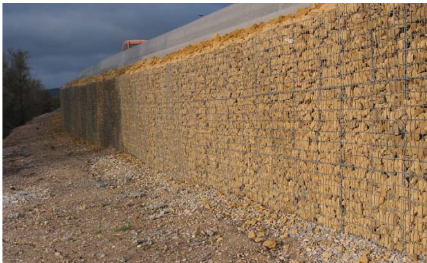
Figure 8. Aspect général du mur M3S®.
