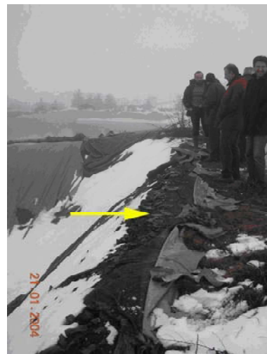
Figure 5. DEG totalement déchiré sur talus exposé au sud entre bassins 1 et 2
