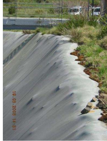
Figure 12. Talus du bassin aéré (1), exposé à l'est
