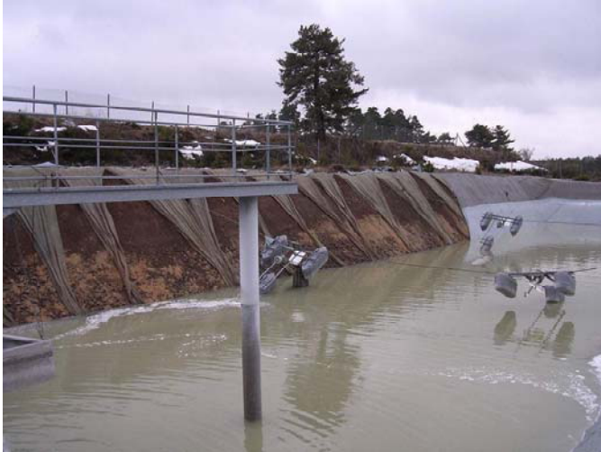
Figure 7. Talus nord du bassin aéré, exposé au sud totalement dégarni
