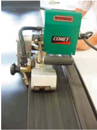
Figure 4. Soudure avec canal de contrôle
