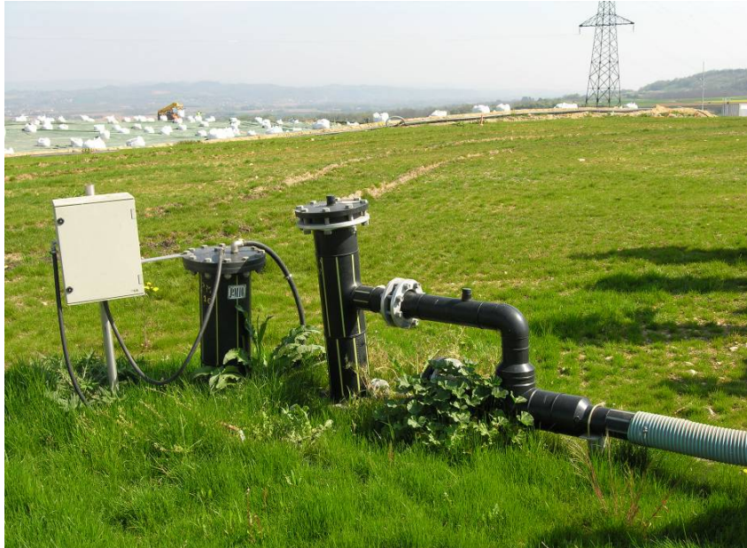
Figure 3. Dispositif de captage du biogaz sur une installation de stockage de déchets.
