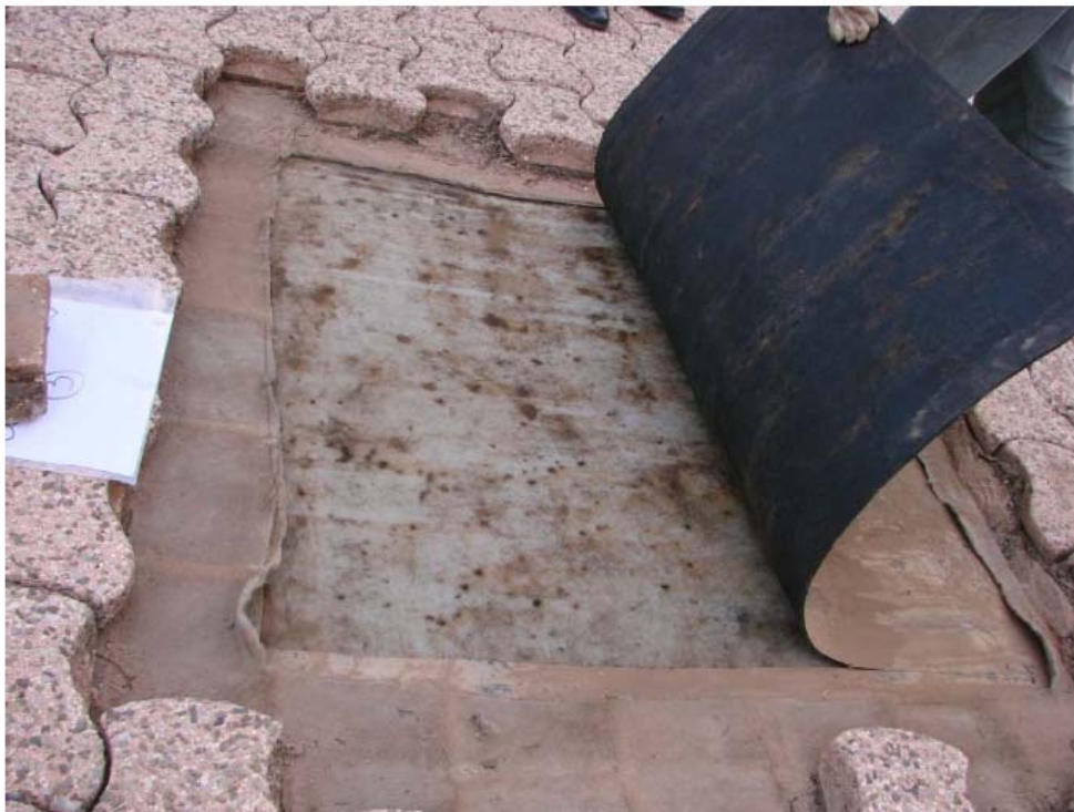
Figure 3. Aspect des surfaces de la géomembrane du site 6 au moment du prélèvement
