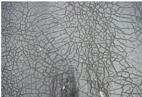
Figure 4. Détail des craquelures de la géomembrane bitumineuse du terril de Watrelos - effet peau de Lézard (Photo : Gisbert, 2008)
