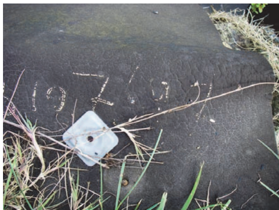
Figure 5. Figure de vieillissement d'une géomembrane bitumineuse élastomère, © TERANAP331TP SIPLAST (Photo : Gisbert)
