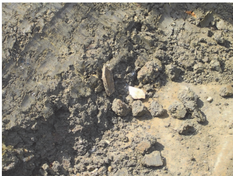
Figure 3. Présence de morceaux de tuiles dans le sol de recouvrement du GSB
