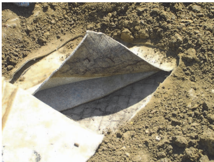
Figure 4. Visualisation du point triple de recouvrement du géotextile situé au-dessus du GSB
