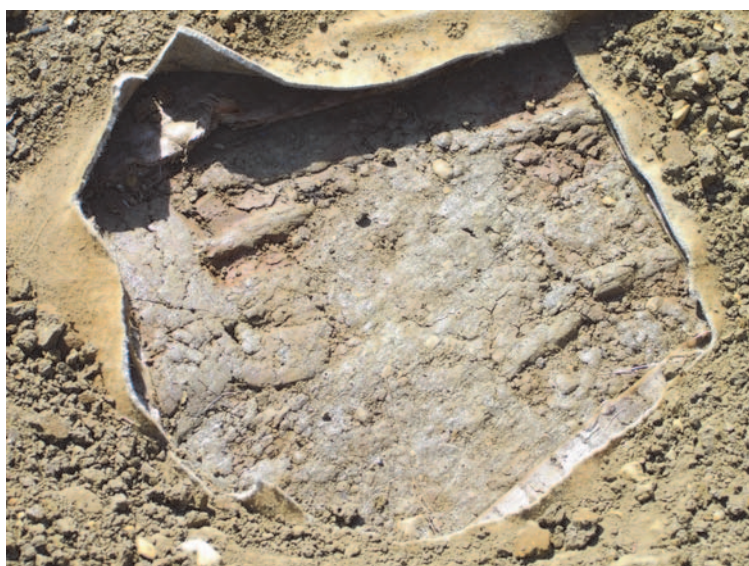
Figure 5. Présence de racines à la surface du sol support du GSB après prélèvement de l'échantillon de GSB sur la première excavation
