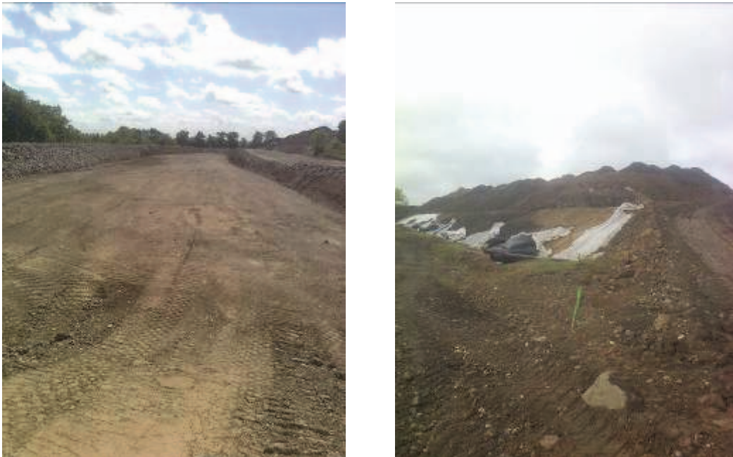
Figure 1. Terrassement du casier (cliché de gauche) après déplacement des stocks de résidus sur l'alvéole « Ouest » (cliché de droite)
