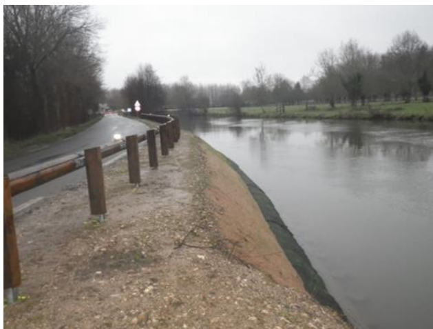
Figure 3. Berge traitée en bordure de route
