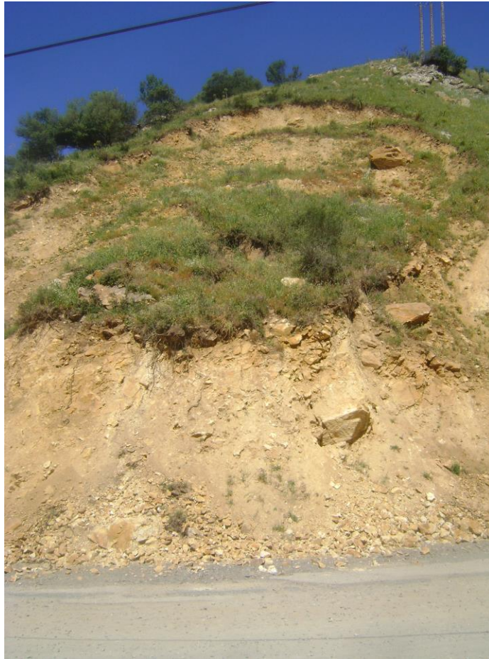
Figure 13. Glissement régressif du talus
