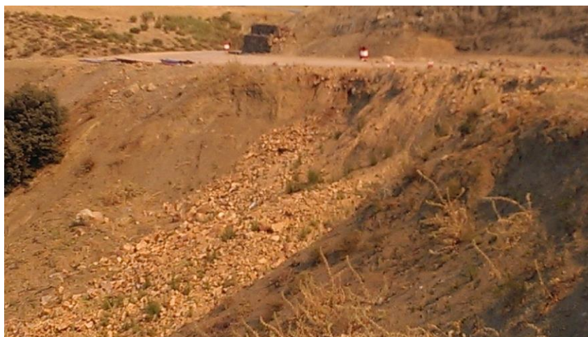
Figure 5. Vue de la route et de l'instabilité
