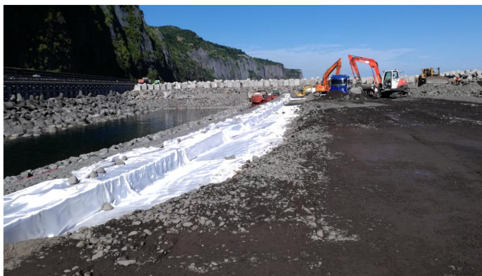
Figure 12. Talus raidi - Mise en œuvre du géotextile de renfort et compactage du remblai structurel
