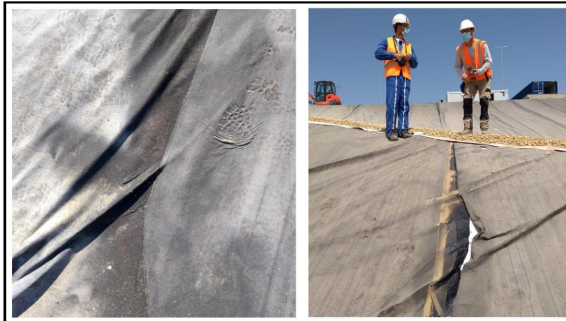
Figure 9. Désordres liés aux conditions climatique (vent et fortes températures)
