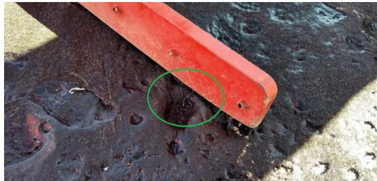
Figure 10. Détection de défaut mineur par la méthode de l'arc électrique
