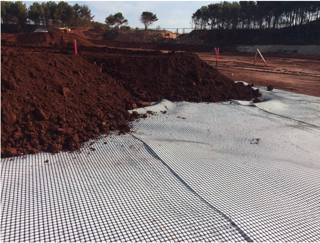
Figure 5. Installation du géocomposite de stabilisation lors de la réalisation de la piste centrale.
